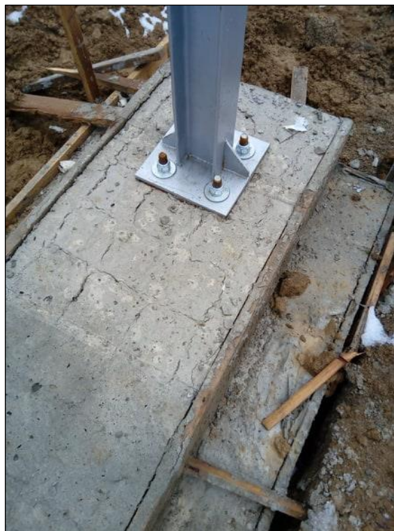
Fig. 4 – Fundația crăpată a totemului SCM montat la Mădârjac
